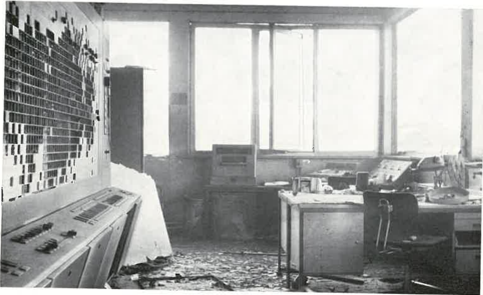
Der Kristallisationspunkt der Explosion: Die Schaltzentrale im Maschinenhaus. Die Einrichtung mit dem Schalttableau (links) ist vom Explosionsdruck und von den Stichflammen zerstört worden.
